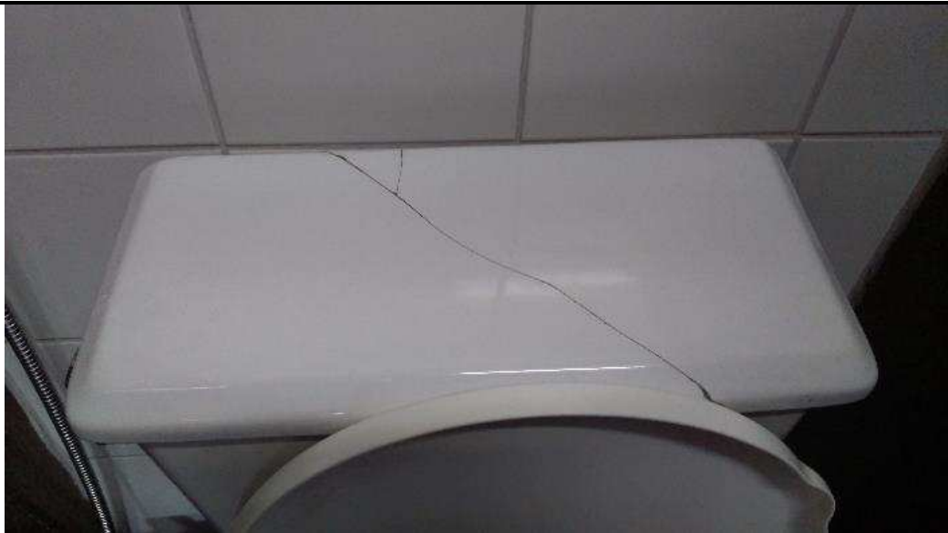
Figura 16: Trinca na tampa da caixa acoplada do vaso sanitário.
