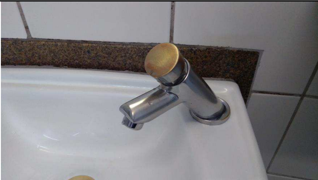
Figura 18: Metais desgastados e constantemente apresentando problemas
