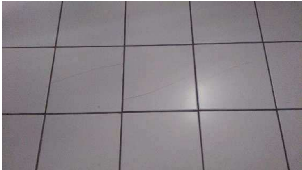
Figura 12: Trincas na cerâmica.
