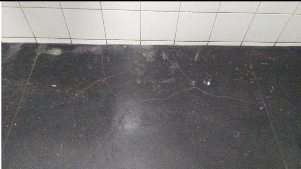
Figura 07: Piso desnivelado, acumulando água e com várias trincas.
