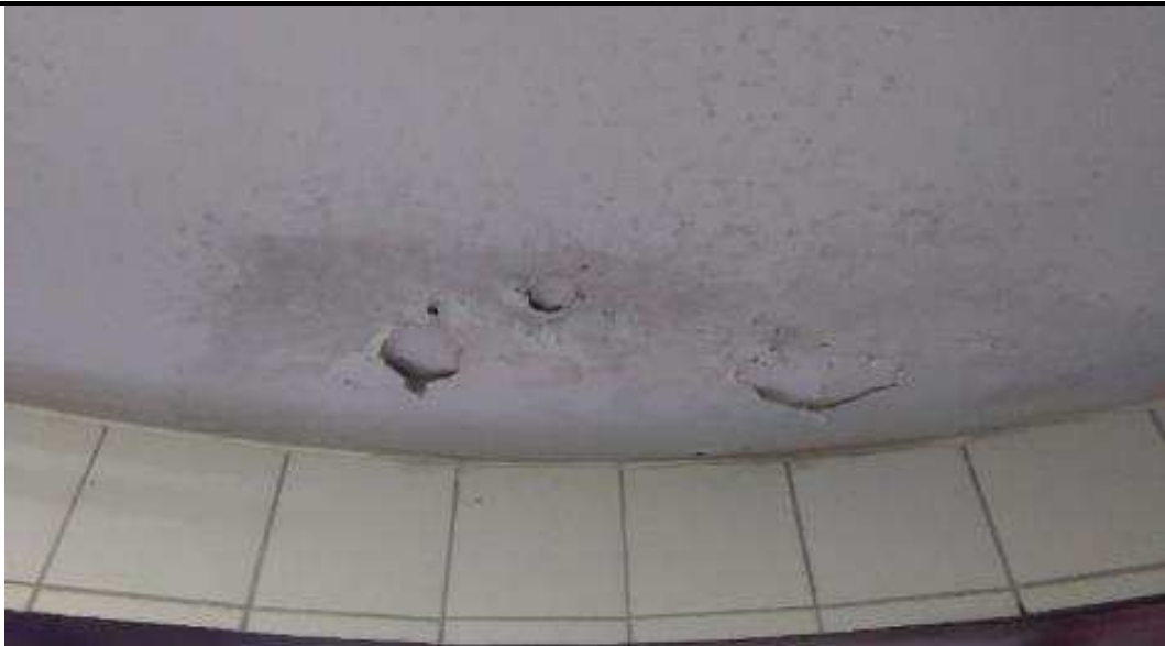
Figura 11: Forro de gesso danificado por infiltração.
