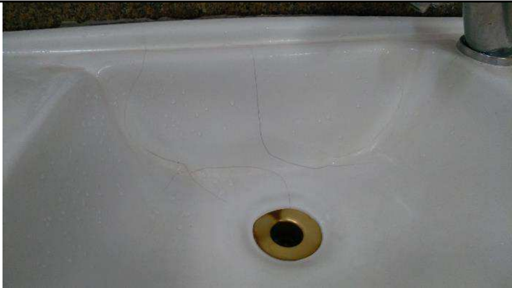
Figura 14: Lavatório com trincas.
