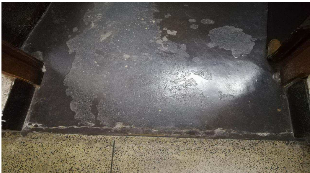
Figura 08: Piso desgastado, desnivelado e acumulando água
