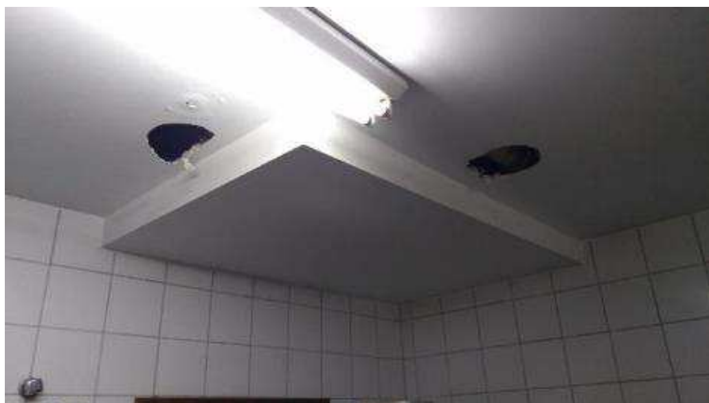
Figura 10: Forro de gesso danificado por vazamento causado no sanitário superior.
