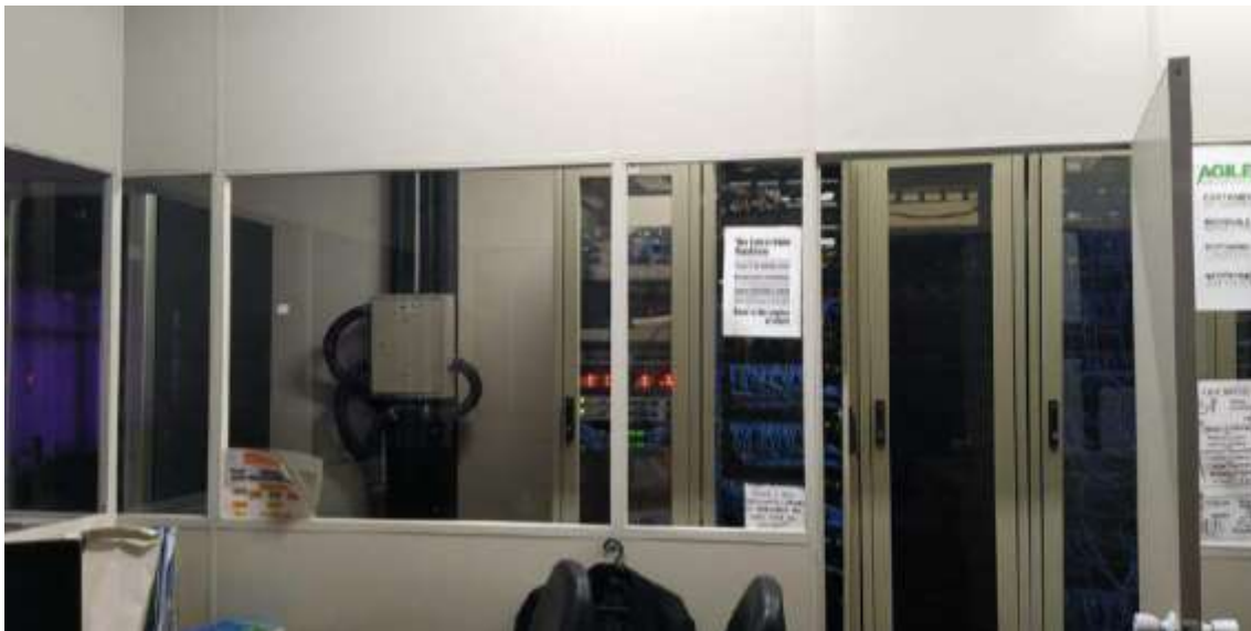
Figura 03: Vista do Data Center e quadro de distribuição.
