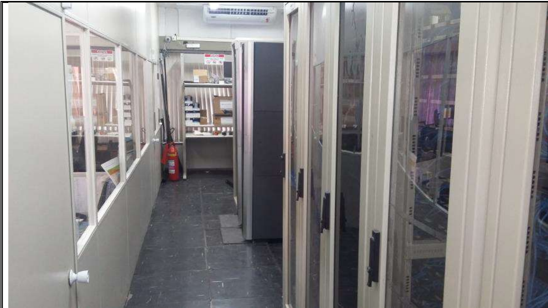
Figura 04: Vista interna da Sala de Telecomunicações do TCEES.
