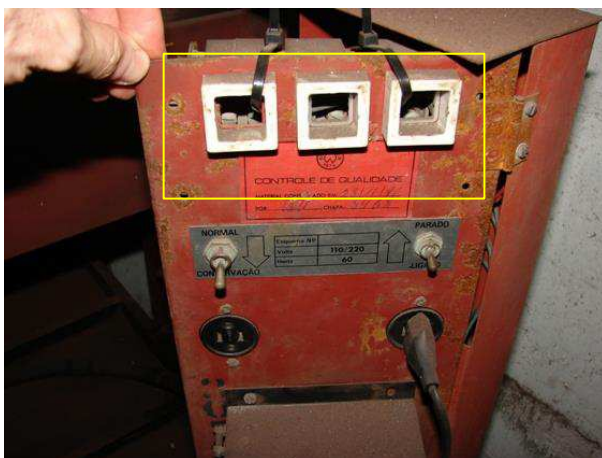
FOTO 15 – Detalhe da botoeira de inspeção instalada no topo do carro do ELEVADOR DO FUNDO.
