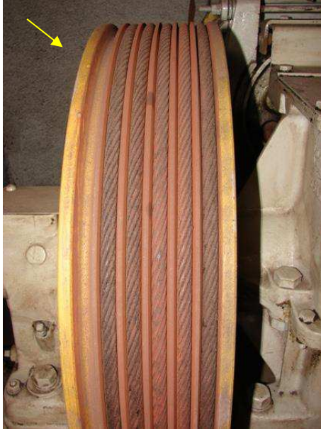
FOTO 1 – Detalhe da polia de tração do ELEVADOR DO FUNDO sem a proteção que prevê a norma NBR NM 207.
