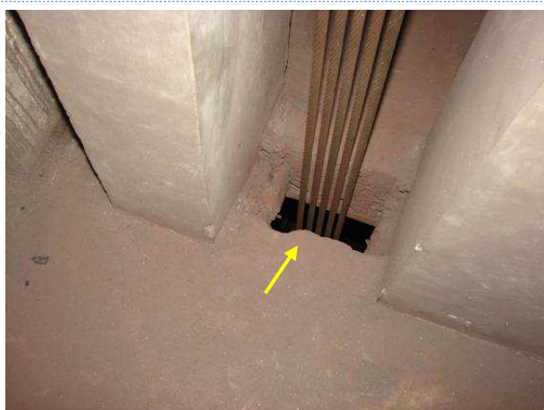
FOTO 24 – Detalhe da ausência de ressaltos de proteção, nos furos de passagem dos cabos de tração, no piso da casa de máquinas do ELEVADOR DA FRENTE.
