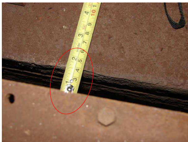
FOTO 19 – Detalhe da distância reduzida entre o painel do fundo da cabina e o contrapeso, no ELEVADOR DO FUNDO.
