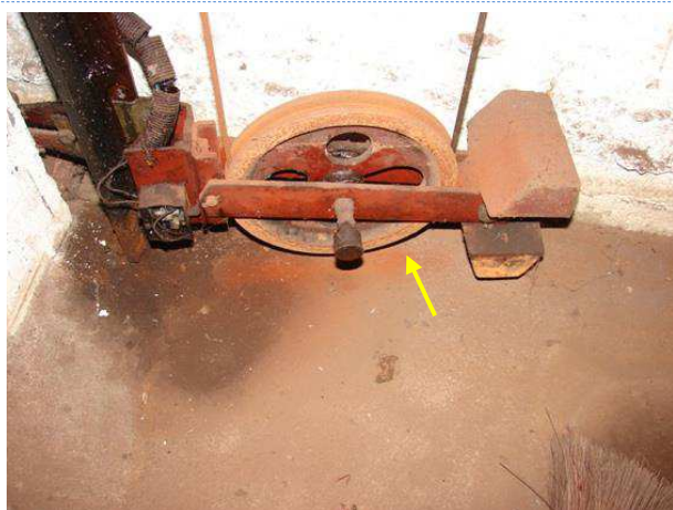
FOTO 18 – Detalhe do dispositivo tensor instalado no poço do ELEVADOR DO FUNDO, totalmente oxidado.
