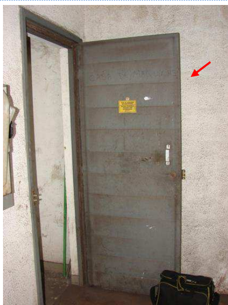
FOTO 20 – Detalhe da porta da casa de máquinas do ELEVADOR DA FRENTE.
