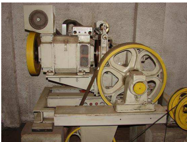
FOTO 3 – Detalhe da máquina de tração do ELEVADOR DA FRENTE de projeto obsoleto e com vazamento de óleo generalizado.
