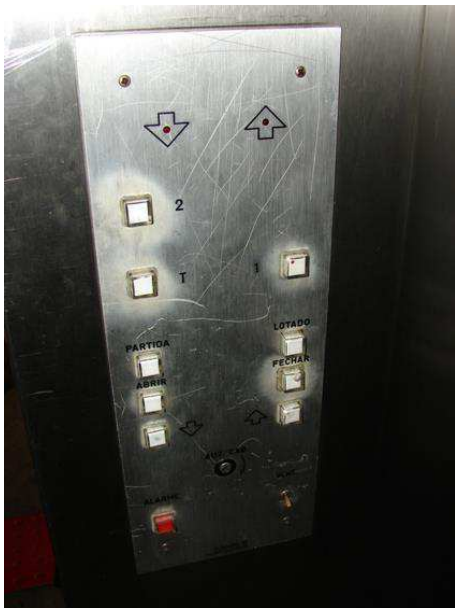
FOTO 13 – Detalhe da botoeira da cabina do ELEVADOR DO FUNDO.
