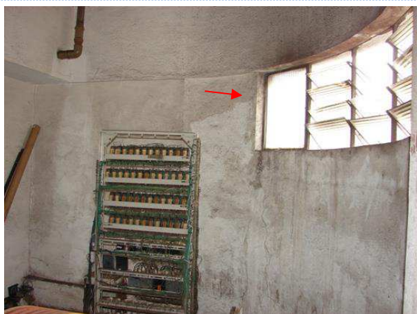
FOTO 23 – Detalhe de aberturas de ventilação na parede do fundo da casa de máquinas do ELEVADOR DO FUNDO.
