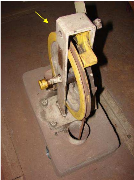
FOTO 2 – Detalhe da polia do limitador de velocidade do ELEVADOR DO FUNDO sem a proteção que prevê a norma NM 207.
