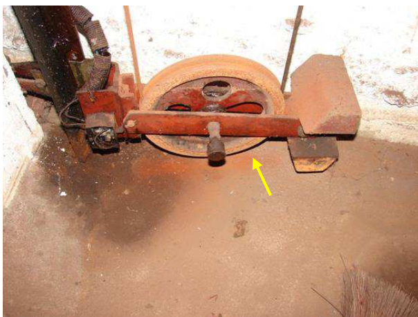
FOTO 18 – Detalhe do dispositivo tensor instalado no poço do ELEVADOR DO FUNDO, totalmente oxidado.
