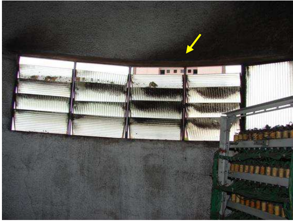
FOTO 22 – Detalhe de aberturas de ventilação na parede do fundo da casa de máquinas do ELEVADOR DA FRENTE.
