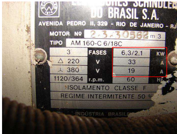
FOTO 4 – Detalhe da placa de características técnicas do motor elétrico do ELEVADOR DO FUNDO.
