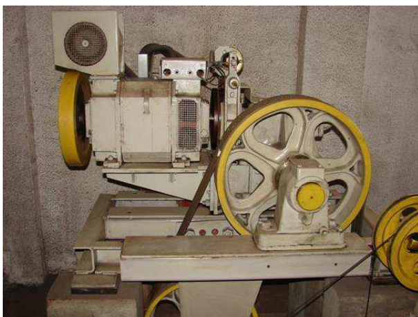
FOTO 3 – Detalhe da máquina de tração do ELEVADOR DA FRENTE de projeto obsoleto e com vazamento de óleo generalizado.
