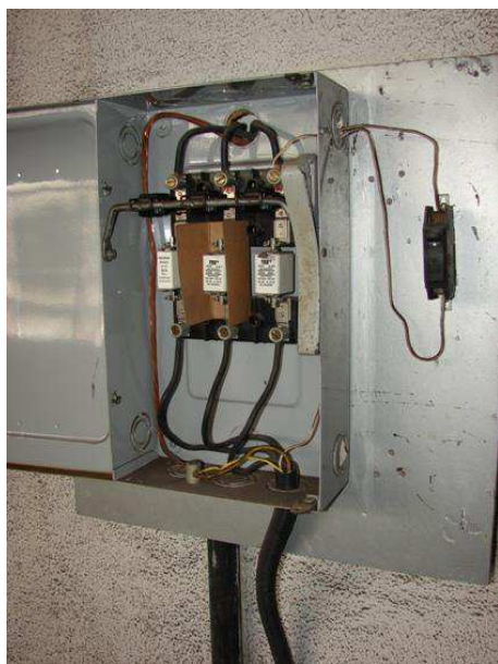
FOTO 21 – Detalhe da chave geral instalada na casa de máquinas do ELEVADOR DA FRENTE.
