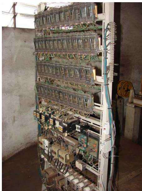
FOTO 6 – Detalhe do painel de comando do ELEVADOR DO FUNDO.
