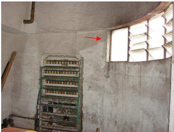
FOTO 23 – Detalhe de aberturas de ventilação na parede do fundo da casa de máquinas do ELEVADOR DO FUNDO.
