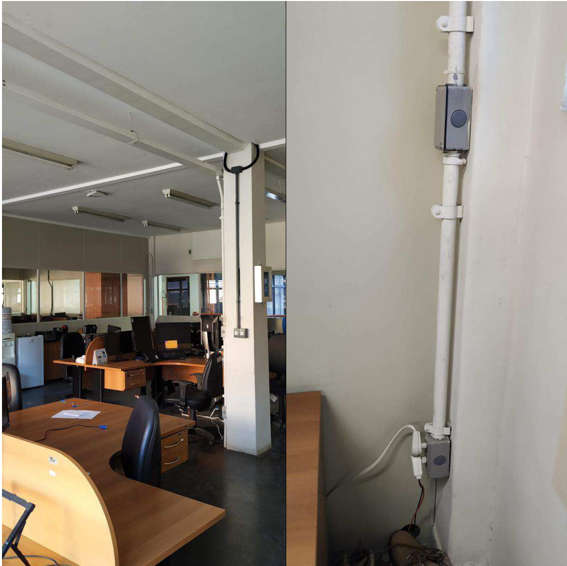
Figura 32 e 33: Instalações aparentes
