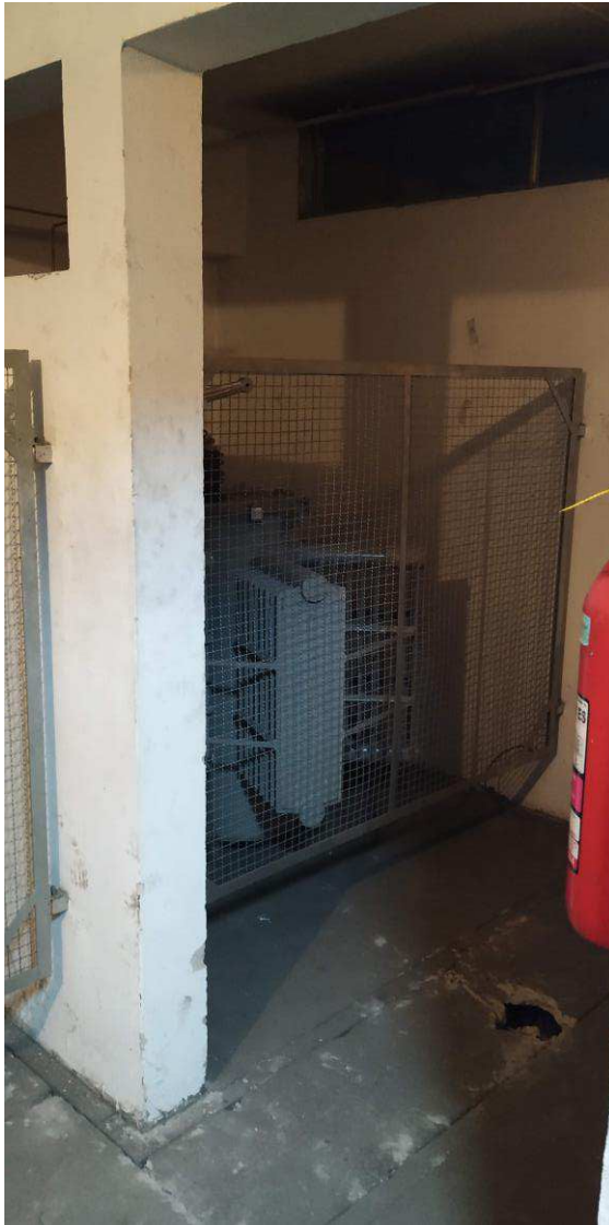
Figura 3: Transformador de 500Kva
