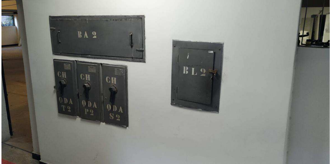
Figura 15: Barramento e chaves gerais no pavimento térreo
