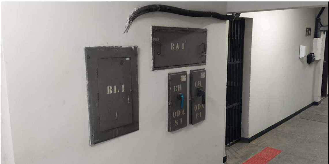
Figura 16: Barramento e chaves gerais no pavimento térreo
