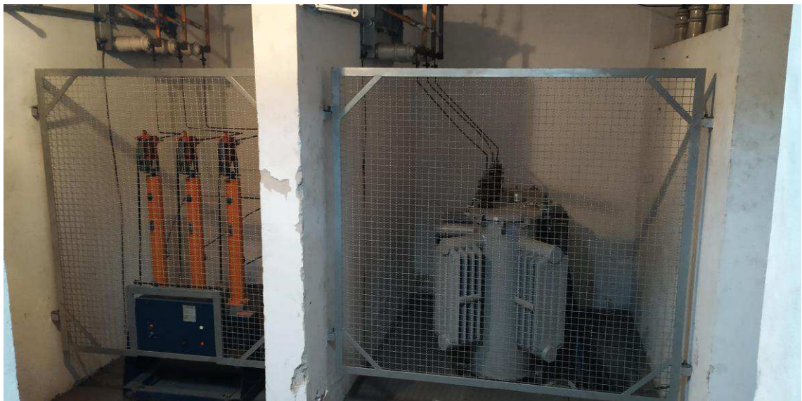
Figura 2: Transformador de 300kVA e disjuntor de média tensão
