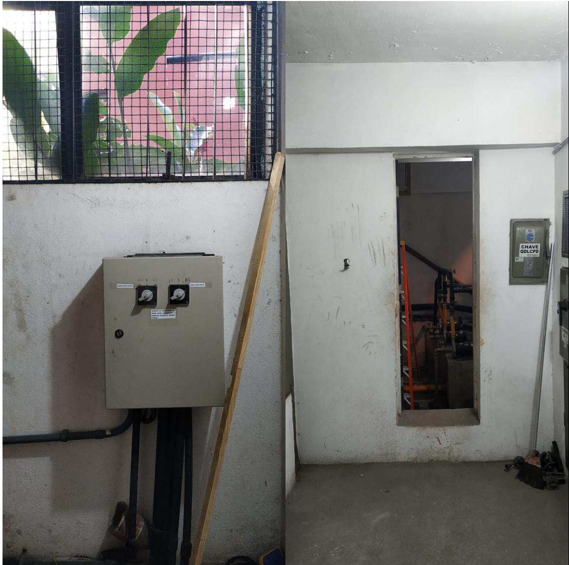
Figura 13: Quadro de comando (casa de bombas)
