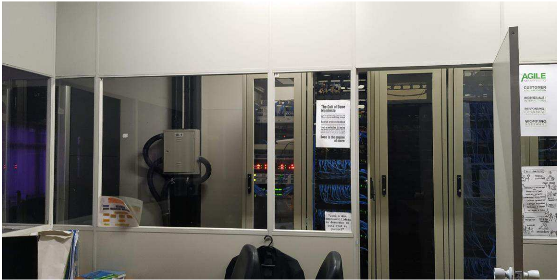
Figura 23: Quadro de distribuição dentro do Data da Center
