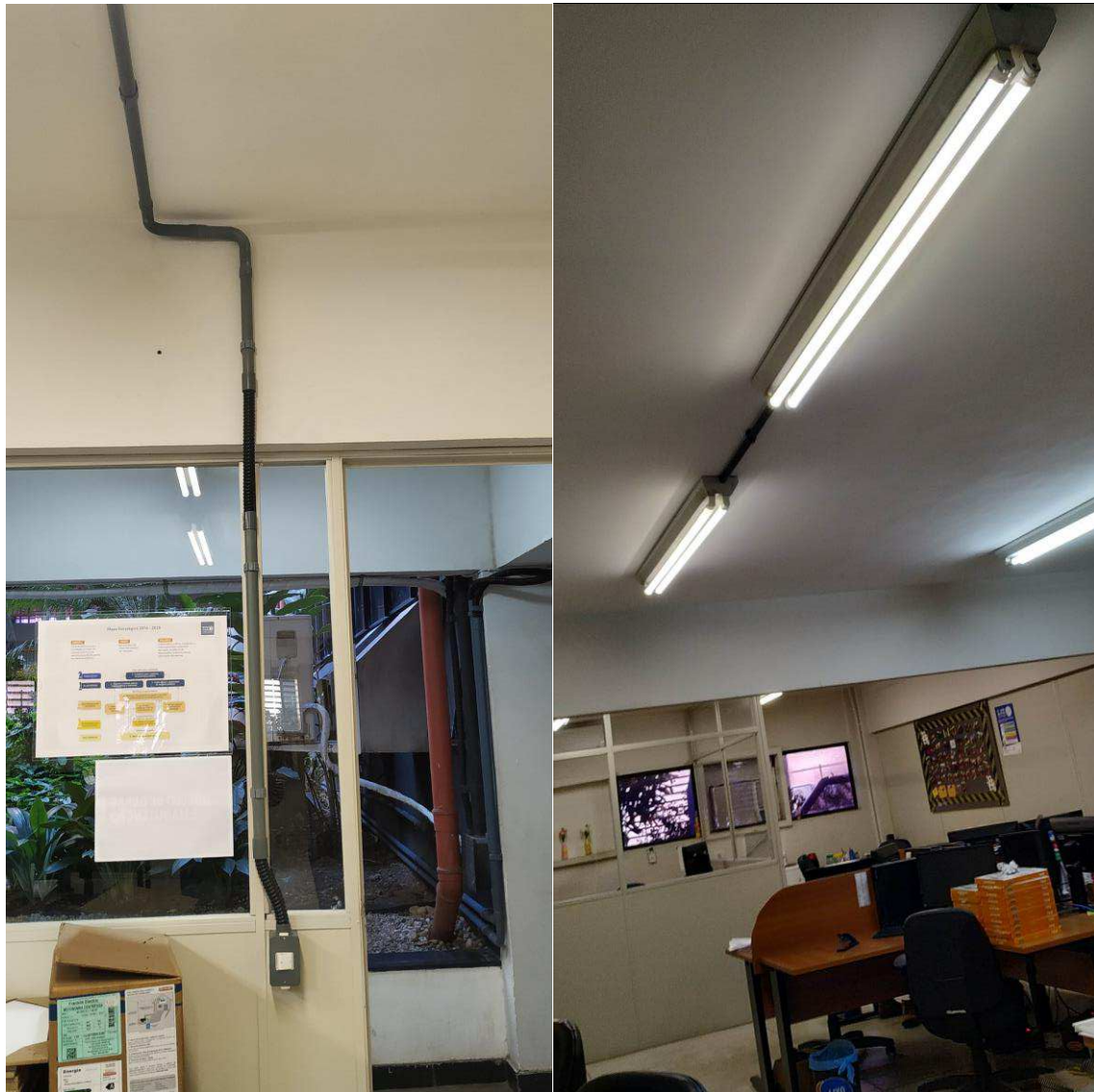
Figura 34 e 35: Instalações aparentes
