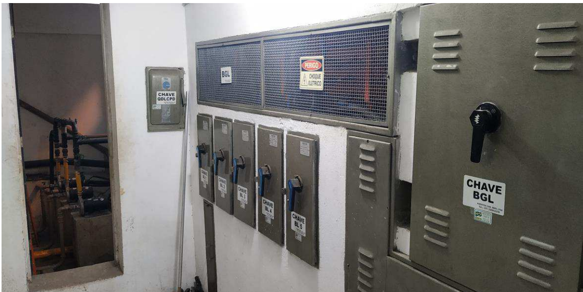
Figura 8: Barramento e chaves gerais do transformador de 300kVA (alimentação de tomadas e iluminação do prédio)
