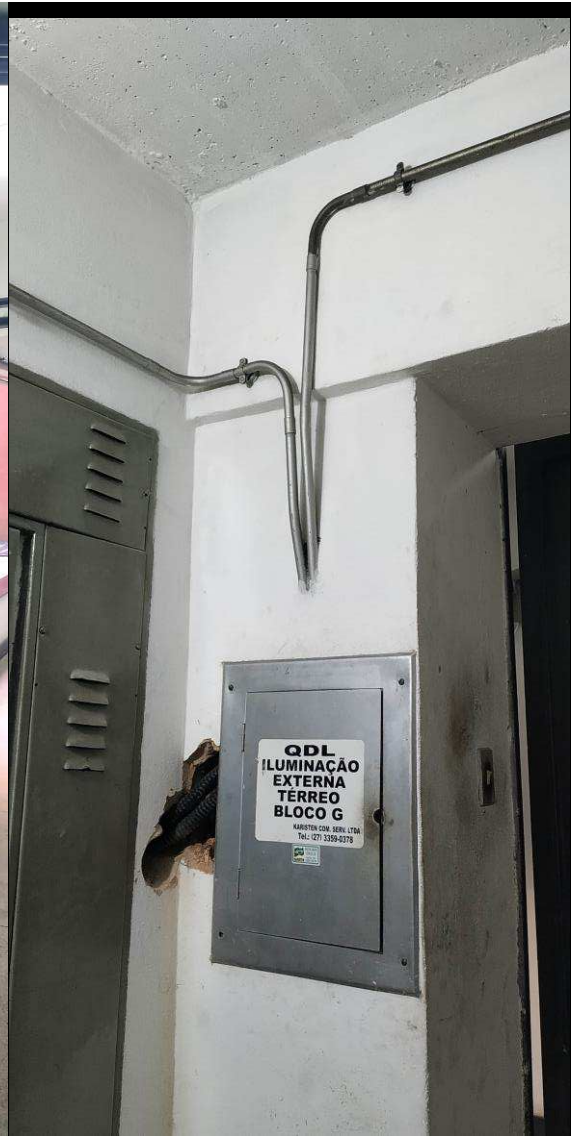
Figura 14: Quadro de distribuição da iluminação externa
