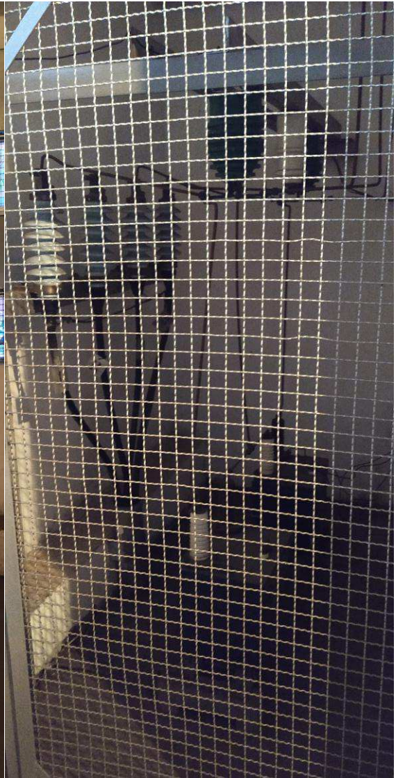
Figura 6: Entrada de energia
