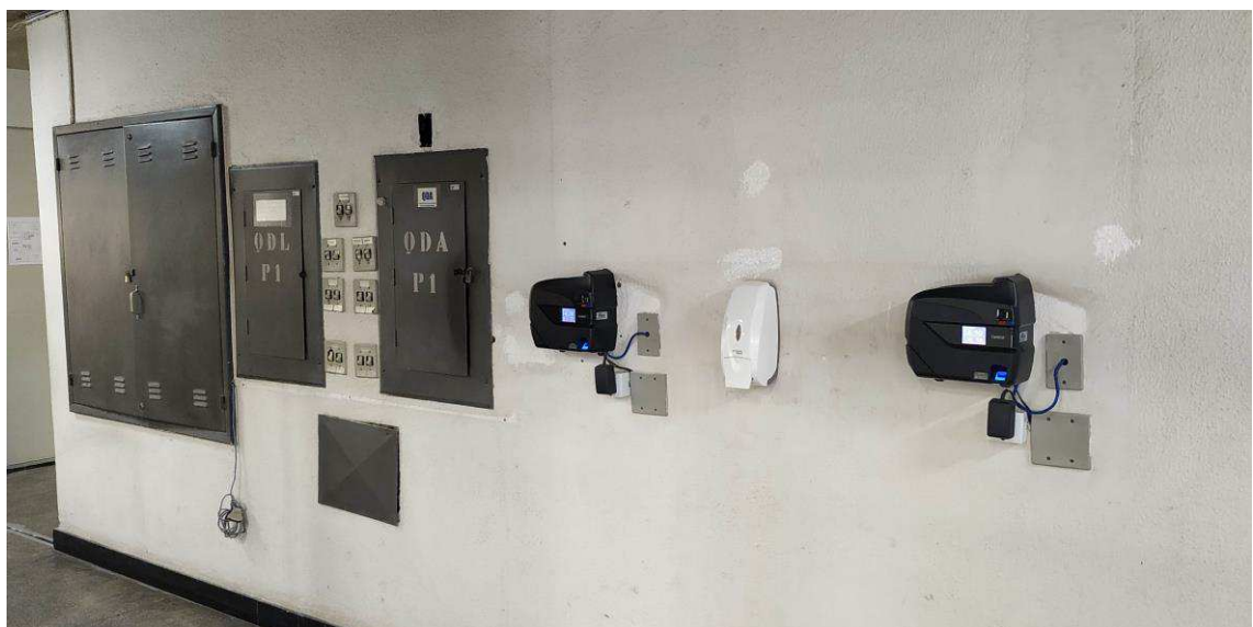
Figura 18: Quadros de distribuição no 1º pavimento
