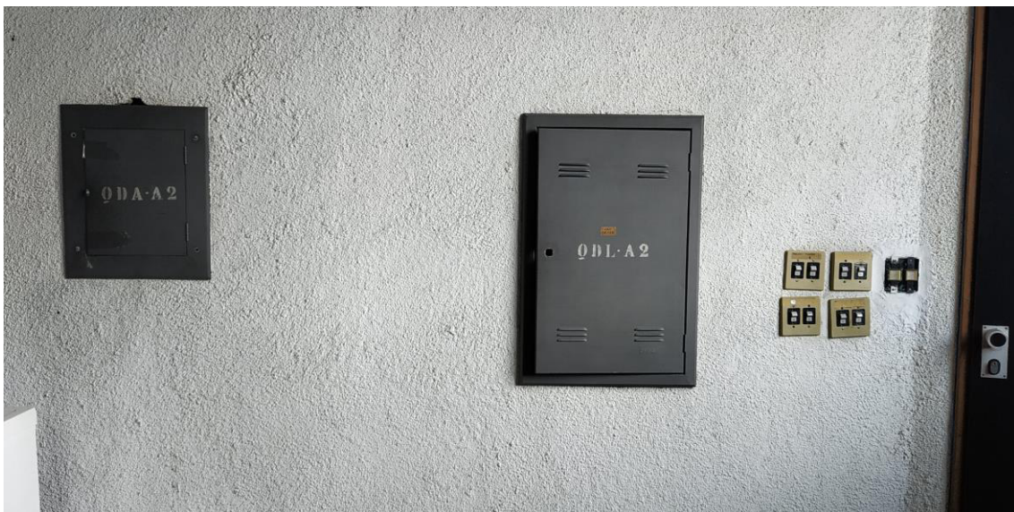
Figura 20: Quadros de distribuição no auditório
