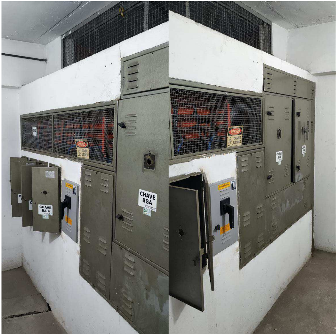
Figura 11 e 12: Barramento e chaves gerais do transformador de 500kVA (alimentação de ar condicionado do prédio)
