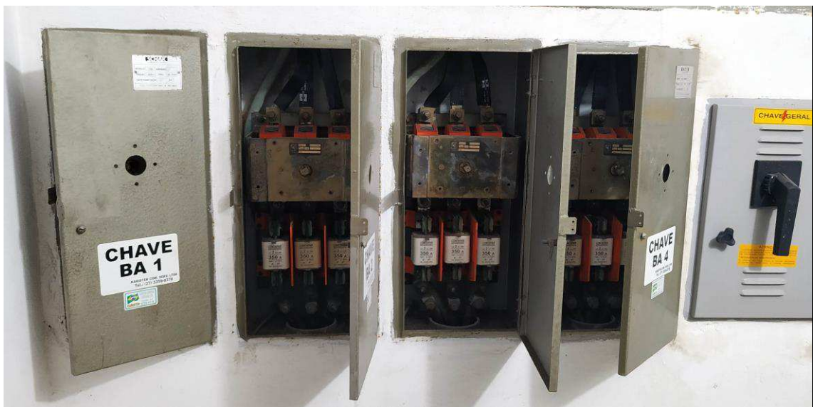
Figura 10: Barramento e chaves gerais do transformador de 500kVA (alimentação de ar condicionado do prédio)
