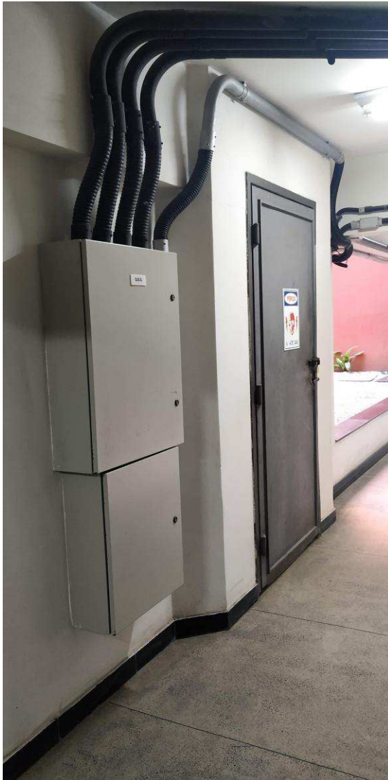
Figura 13: Quadro de Distribuição Geral (QDG)
