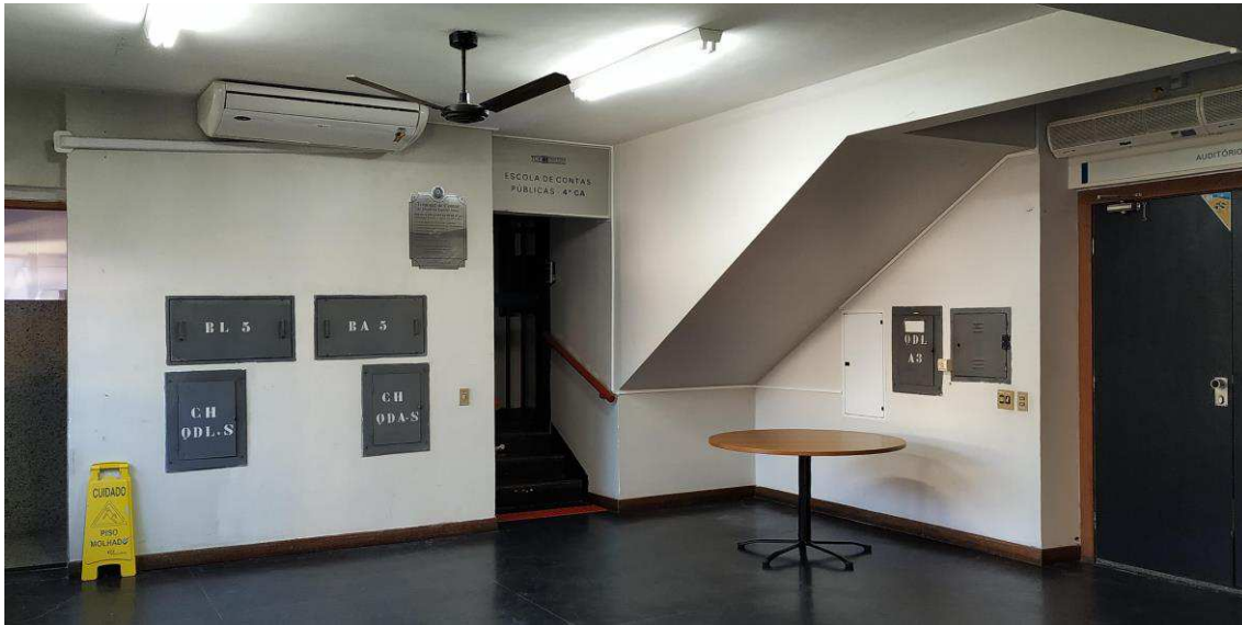
Figura 19: Quadros de distribuição e barramentos gerais do auditório
