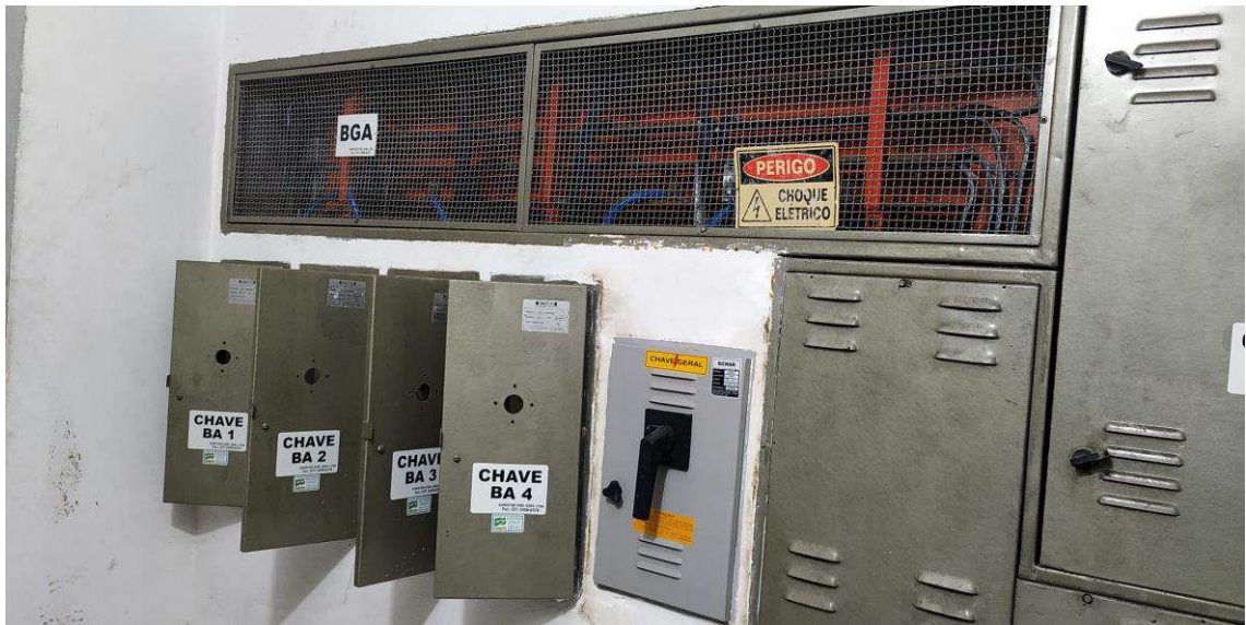
Figura 9: Barramento e chaves gerais do transformador de 500kVA (alimentação de ar condicionado do prédio)
