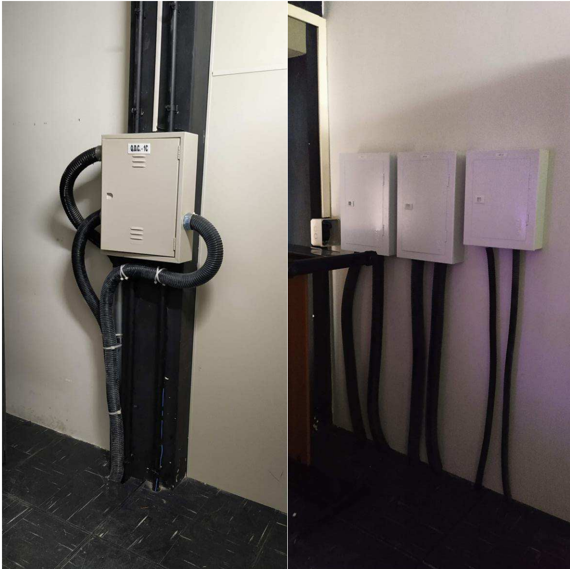
Figura 21 e 22: Quadros de distribuição dentro do Data da Center
