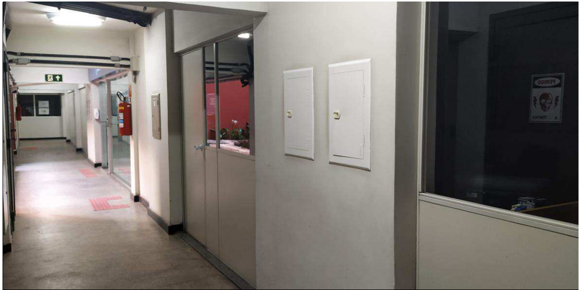
Figura 17: Quadros de distribuição a serem removidos no pavimento térreo
