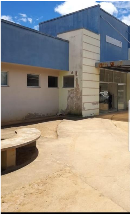
Figura 25 – Frente direita da entrada da Unidade Básica de Saúde Carolina Barbosa em Irupi Fonte: Equipe de fiscalização em 02/03/2021
