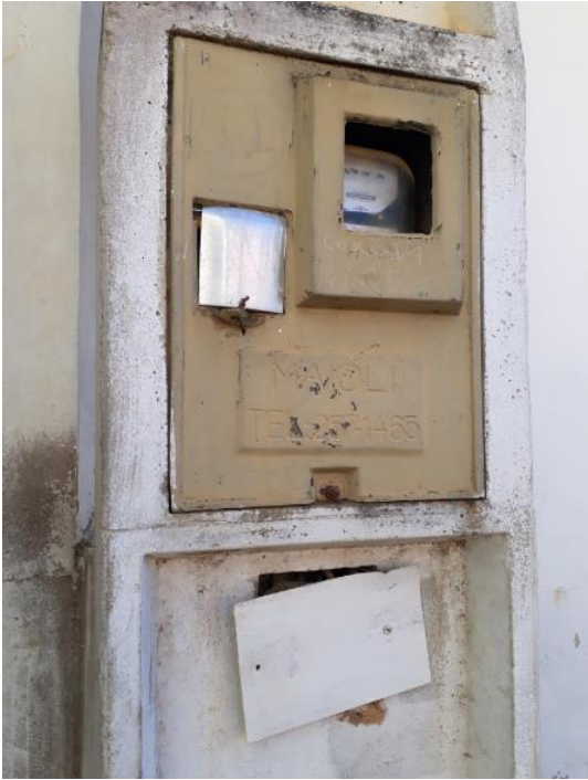
Figura 40. Disjuntor desprotegido em local público (Unidade Sanitária - Rio Bananal )
