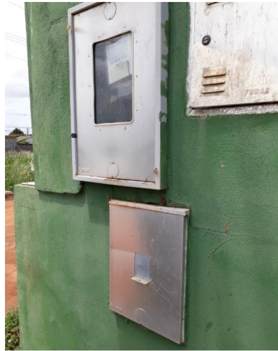
Figura 37. Disjuntor exposto em local público (UBS Marcos Vinicius Souza Santos – Pedro Canário )
