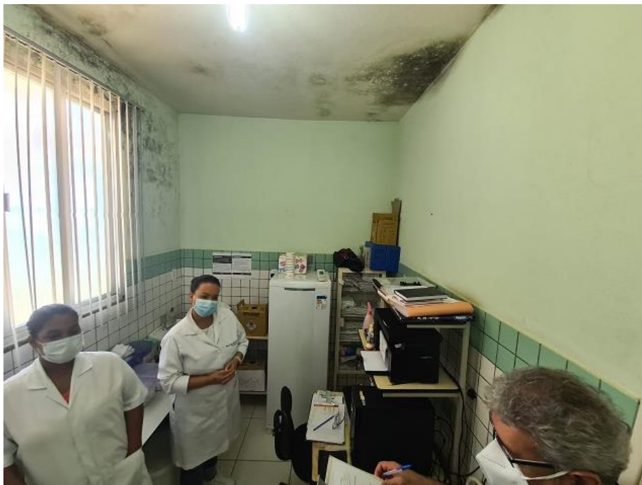
Figura 19. Teto com infiltração e mofo na sala de vacinação (Unidade de saúde da família US3 - Apiacá)
