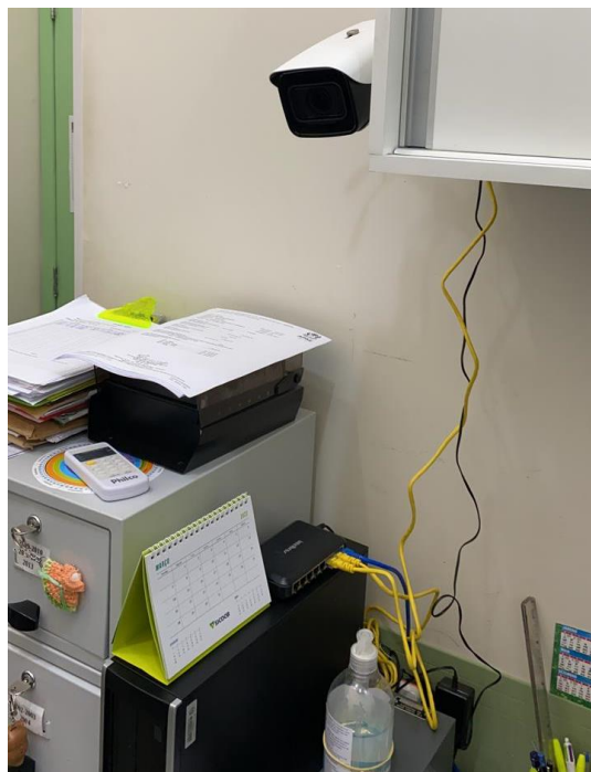
Figura 90 – câmera instalada em frente à câmara refrigeradora Fonte: Equipe de fiscalização
