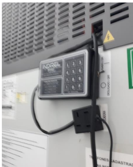
Figura 64. Discadora instalada em câmara de refrigeração (Rede de Frio - Aracruz)
