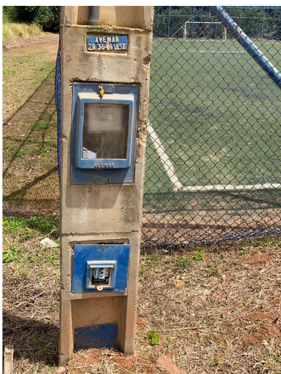
Figura 32. Disjuntor exposto em local público (UBS Sede – Brejetuba )
