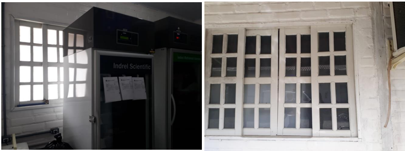
Figura 85 – Estabelecimento de saúde sem grade proteção nas janelas Fonte: equipe de fiscalização
