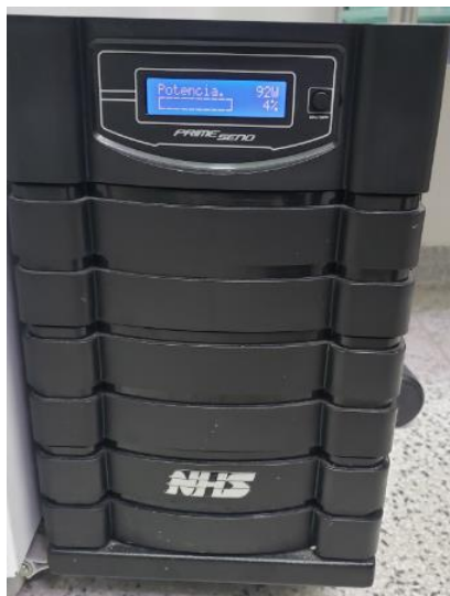
Figura 62. Bateria externa ( nobreak ) acoplada a câmara refrigerada (UBS II - Anchieta)
