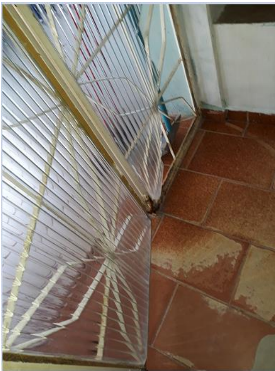
Figura 16. Vidros quebrados e portas enferrujadas (Rede de frios - Boa Esperança)
