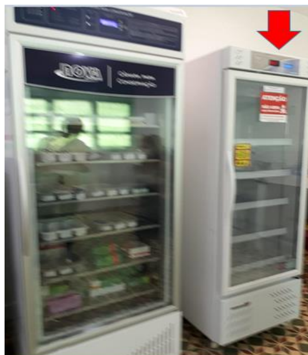
Figura 8. Câmara refrigerada sem utilização (Unidade Sanitária - Ibraçu)
