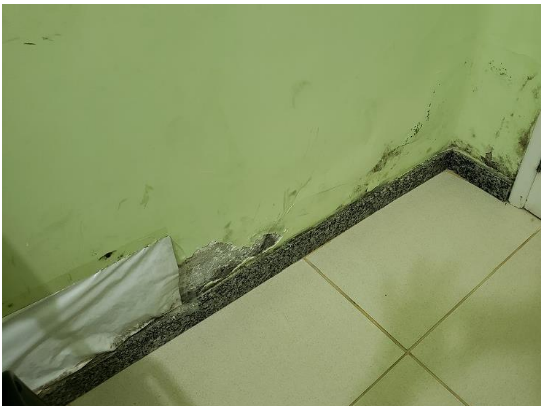
Figura 29. Mofo nas paredes (UBSF Walchimar Santos - Rio Novo do Sul)
