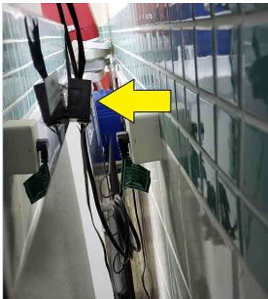
Figura 65. Câmera refrigerada ligada à linha telefônica (USF Dilson dos Santos Loureiro – Vitória)
