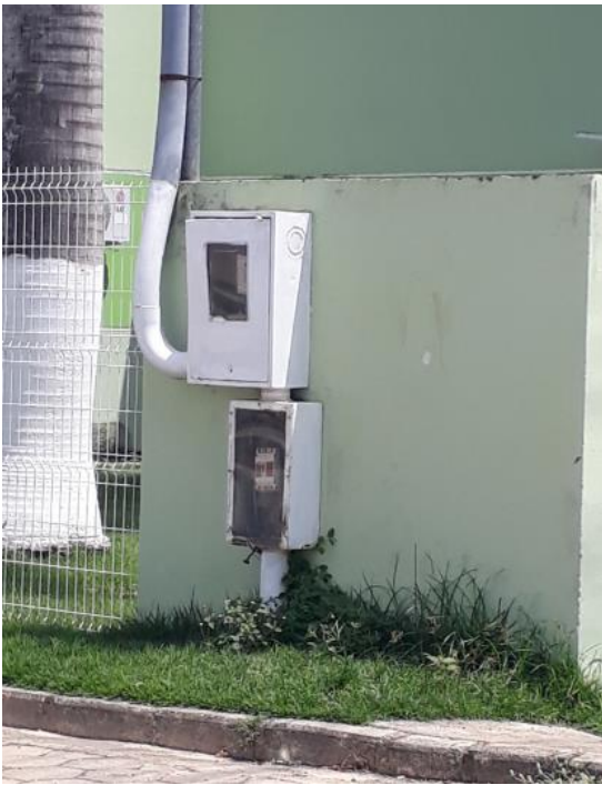
Figura 36. Disjuntor exposto em local público (UBS Galileia – Pinheiros )
