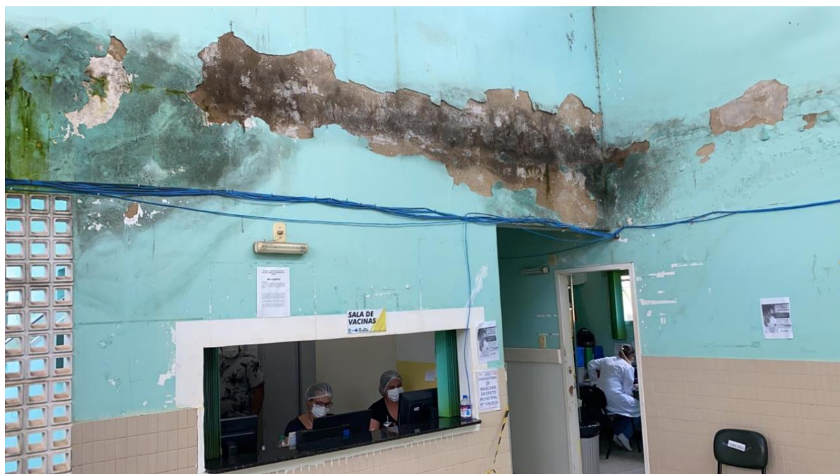
Figura 10. Infiltração na sala de vacinação (UBS Adiláo Almeida de Lima – Ibatiba)
