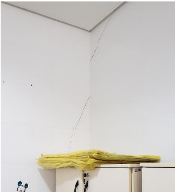
Figura 27. Rachadura nas parede e noteto (sala de vacinação do Centro Municipal de Saúde - Guarapari)
