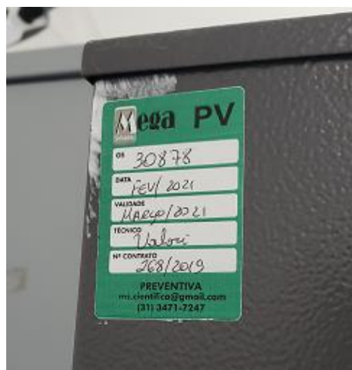
Figura 68. Registro da última manutenção preventiva em câmara refrigerada (Unidade Parque Residencial Laranjeiras - Serra)
