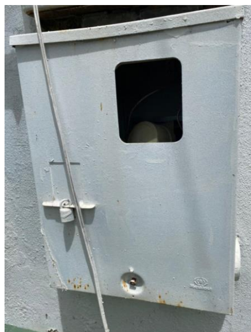
Figura 35. Disjuntor exposto em local público (ESF Santa Cruz – Irupi )
