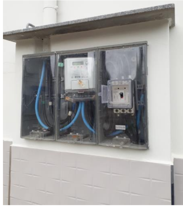
Figura 41. Disjuntor exposto em local público (Unidade Básica Gadioli – João Neiva )
