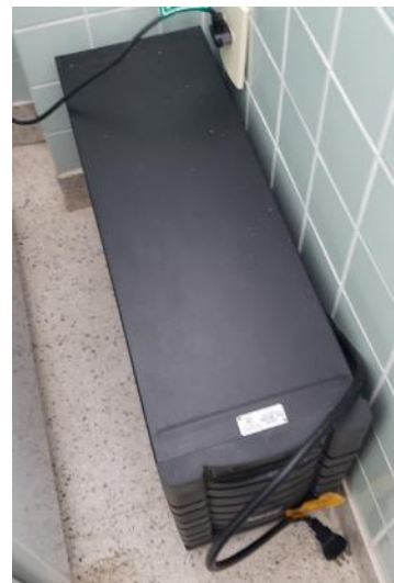
Figura 63. Bateria externa ( nobreak ) adquirida para câmaras refrigeradas sem utilização (Pronto Atendimento - Anchieta)
