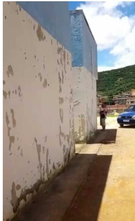
Figura 26 – Parede externa ao lado direito da Unidade Básica de Saúde Carolina Barbosa em Irupi Fonte: Equipe de fiscalização em 02/03/2021
