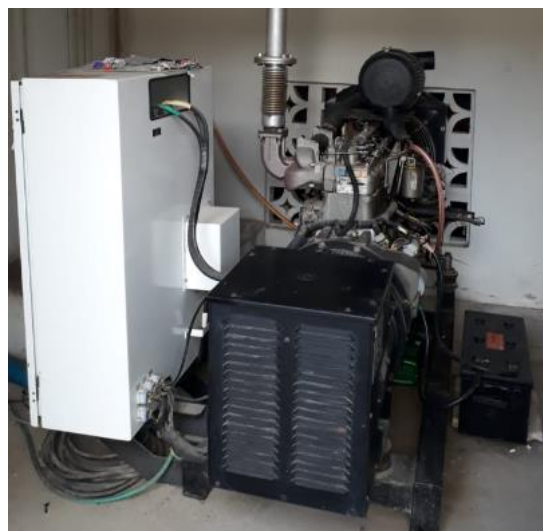
Figura 55. Gerador do PA, onde está ligada uma das câmaras (Rede de Frio - Jaguaré)
