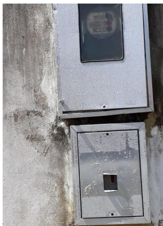
Figura 33. Disjuntor exposto em local público (USF no Bairro Santana – Conceição da Barra )
