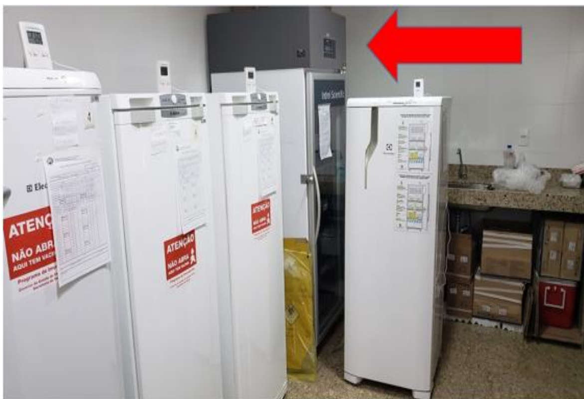
Figura 6. Câmara refrigerada sem utilização há 7 anos por falta de manutenção (Rede de Frios no Centro Municipal de Saúde - Guarapari)
