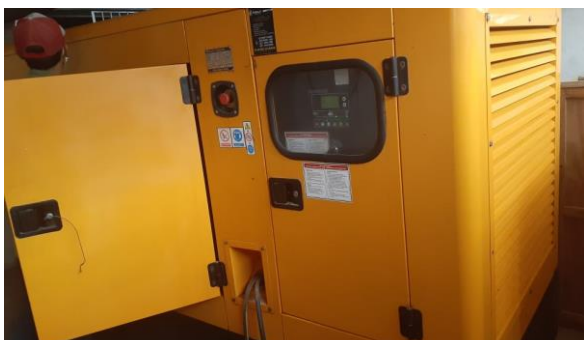
Figura 54. Gerador para todo o estabelecimento (Pronto Atendimento - Anchieta)
