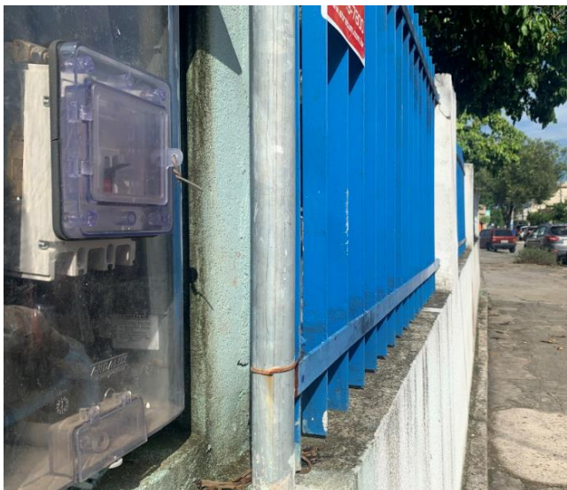
Figura 38. Disjuntor desprotegido em local público (UBS Araçás – Vila Velha )
