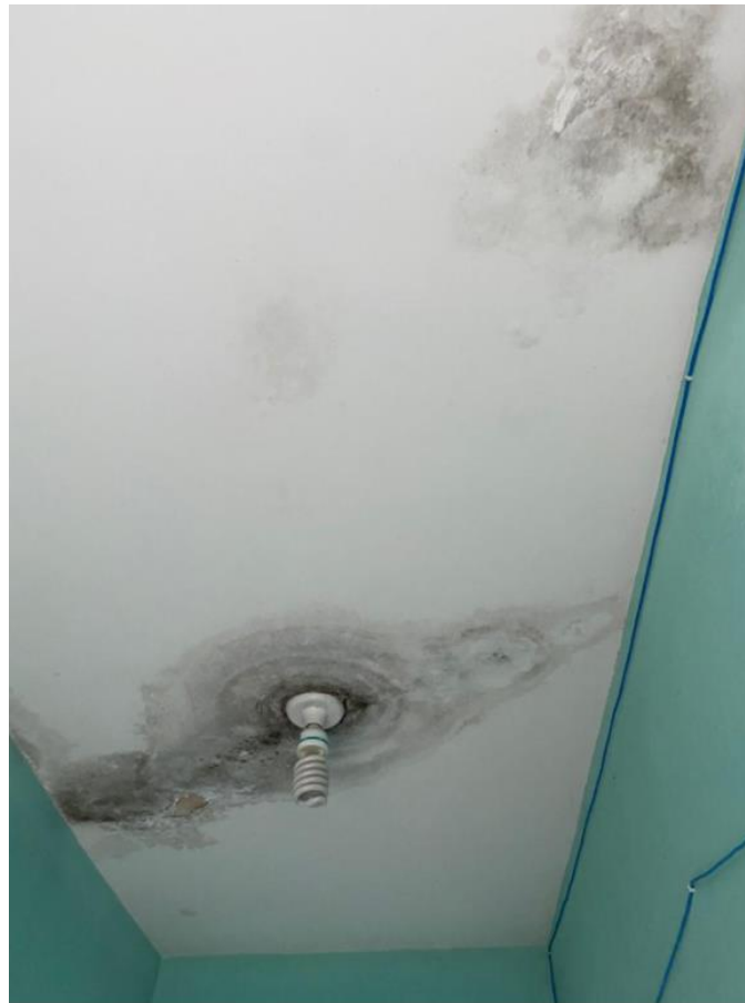
Figura 11. Infiltração na parte elétrica (UBS Adilão Almeida de Lima no município - Ibatiba).
