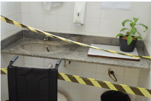
Figura 12. Banheiros sem condições de uso disponibilizados para a população (Sala de vacinação em Timbuí - Fundão)
