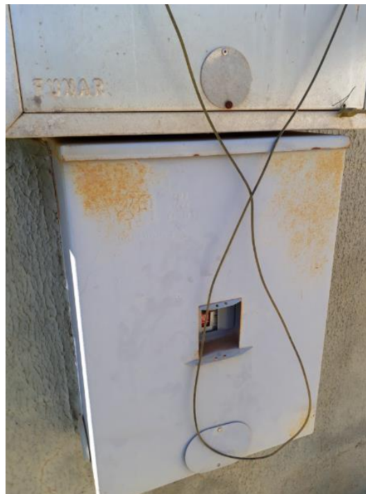
Figura 39. Disjuntor exposto em local público (UBS São Francisco – Rio Bananal )
