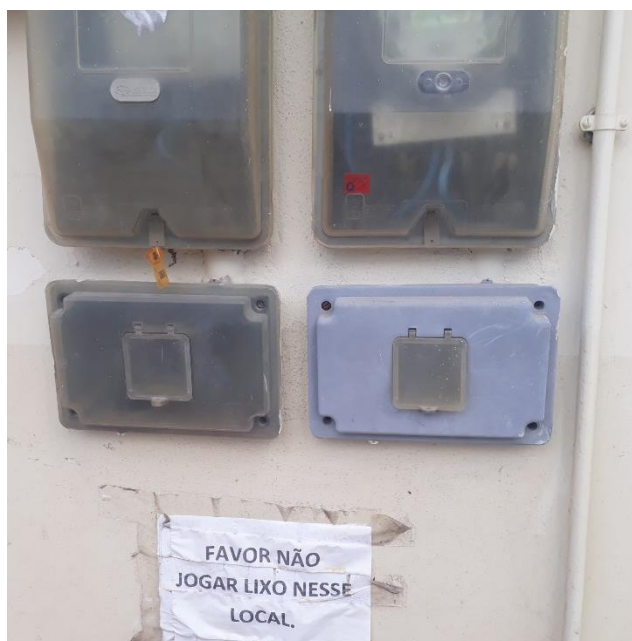
Figura 34. Disjuntor desprotegido em local público (UBS Nossa Senhora da Conceição - Linhares )
