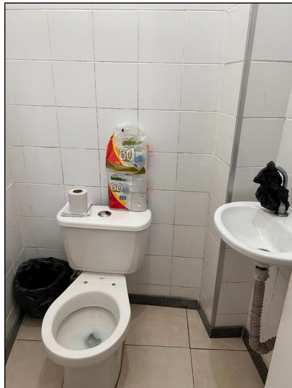
Foto 6: Sanitário sem tampa e torneira quebrada (7º DP - Vila Velha)
