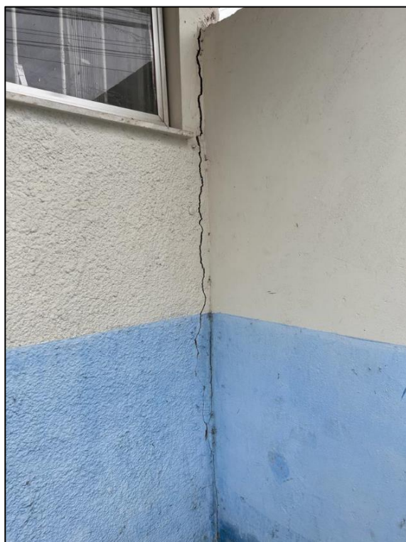
Foto 7: Trincas ou rachaduras nas paredes (9º DP - Vila Velha)
