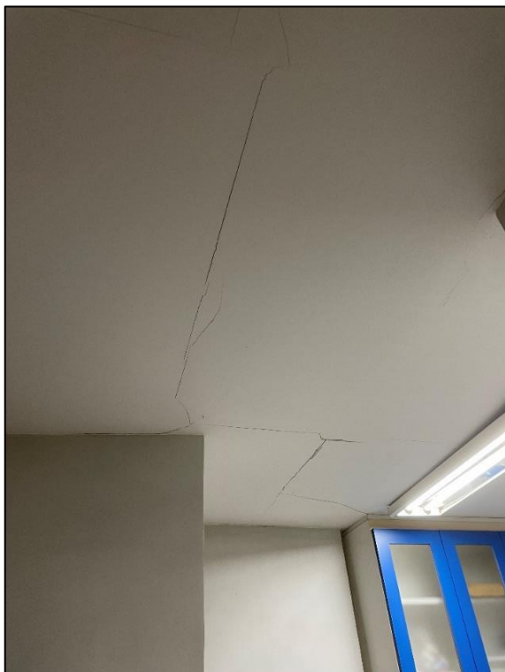
Foto 5: Trincas ou rachaduras no teto (2º DP - Vitória)
