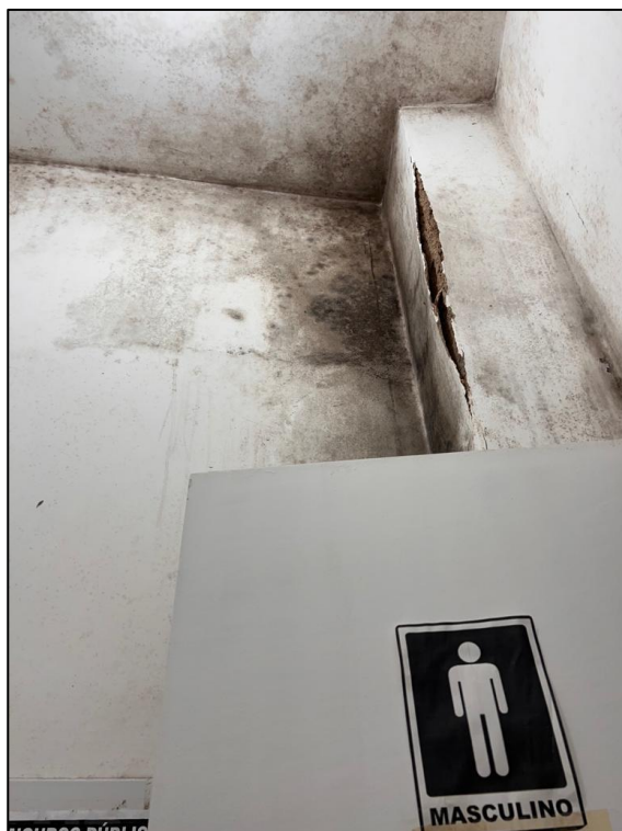
Foto 3: Infiltrações nas paredes (7º DP – Vila Velha)
