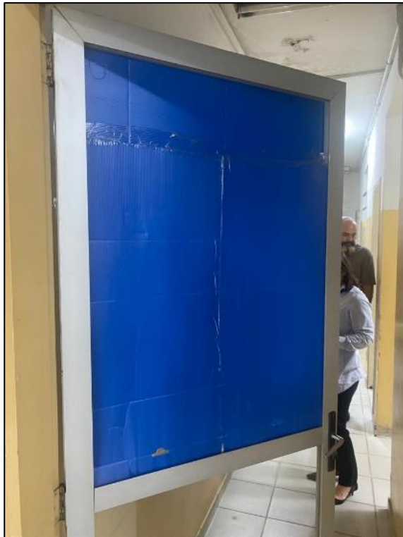
Foto 9: Porta quebrada (9º DP – Vila Velha)
