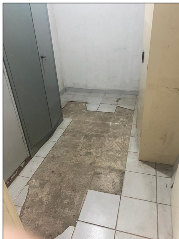
Foto 8: Desprendimento do piso (9º DP - Vila Velha)
