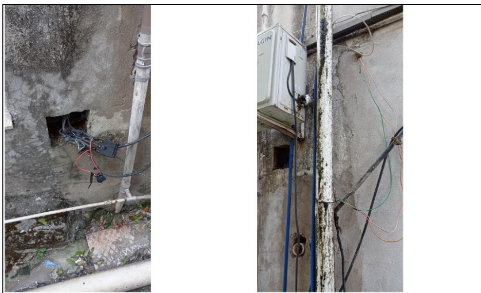
Foto 2: Disjuntor sem proteção (esquerda) e sistema elétrico sem proteção (direita)
